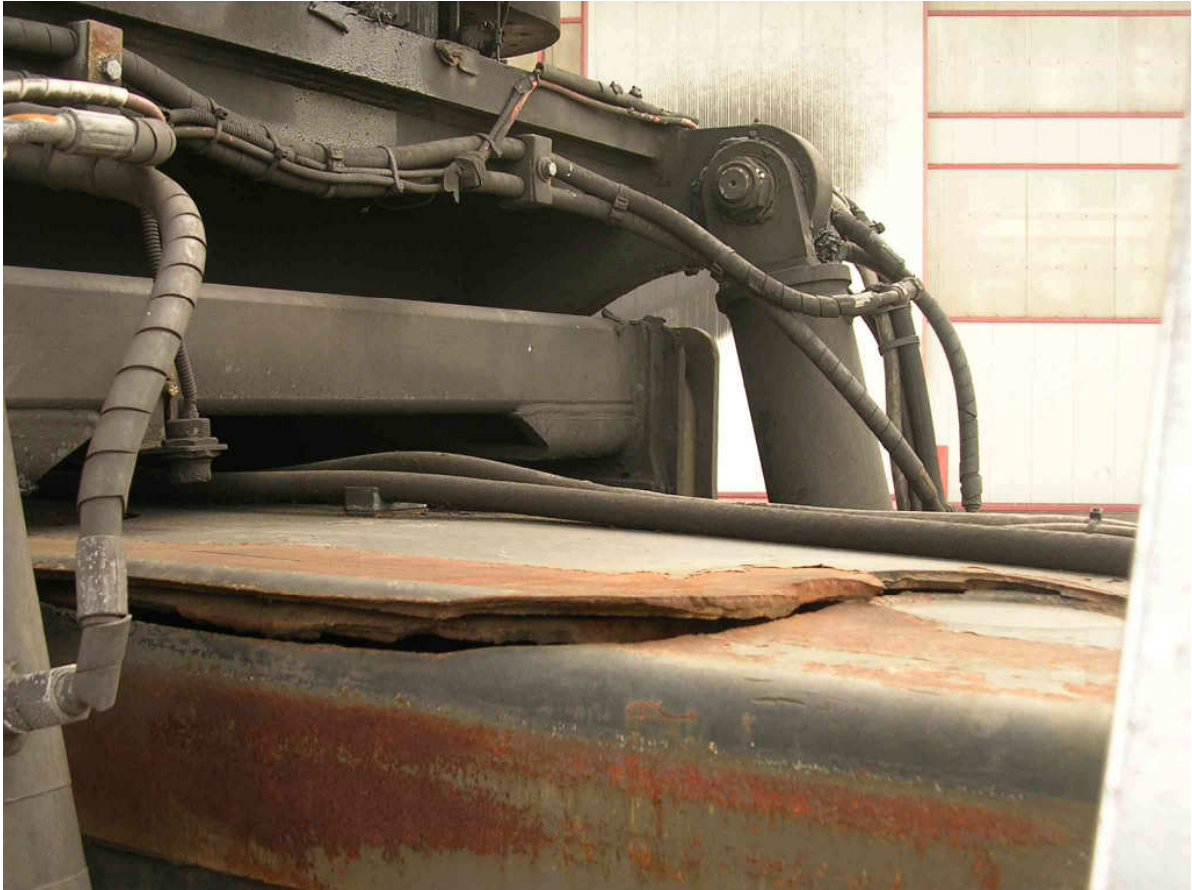
FOTO 7 - FRATTURA DEL CORPO SPREADER – N. 611
