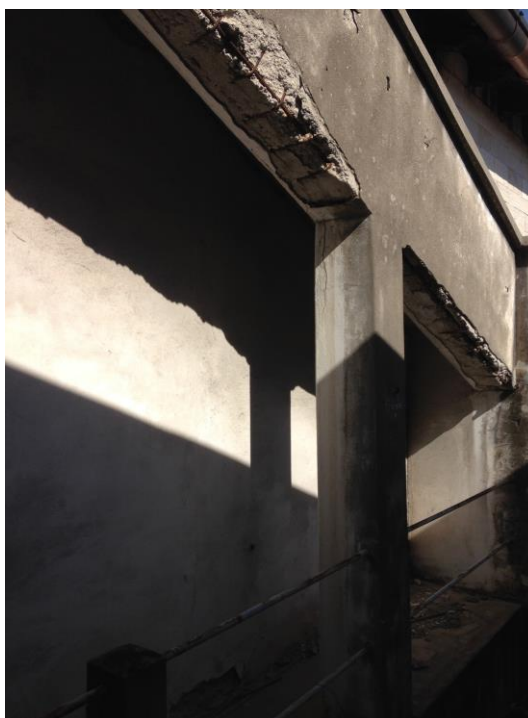
2 – Trave in calcestruzzo armato da ripristinare
