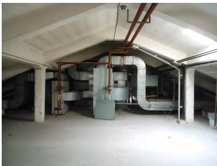
3 – Impianti in disuso da rimuovere nel sottotetto
