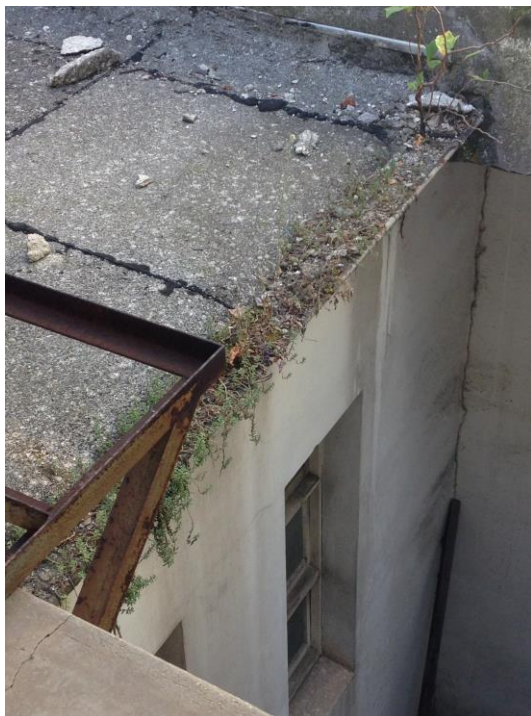
4 – guaina impermeabilizzante da sostituire
