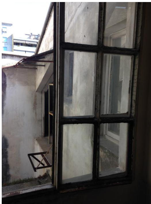
5 – Serramenti in legno e ferro da sostituire
